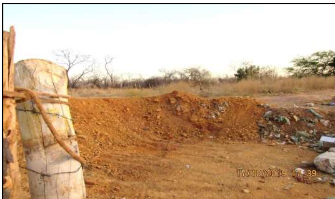
Figura 59 – Solo utilizado para aterrar os resíduos sólidos de João Costa Fonte: NERAR ENGENHARIA (2019)
