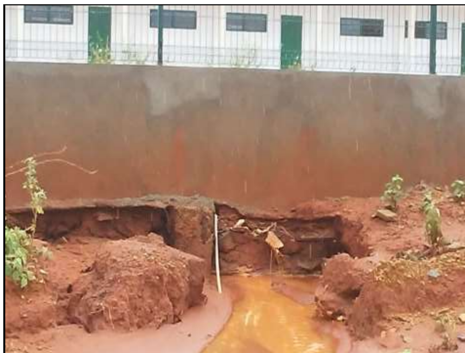
Figura 73 - Cratera na Sede de João Costa (chuva do final do ano de 2019) Fonte: Grupo de Trabalho (2019)
