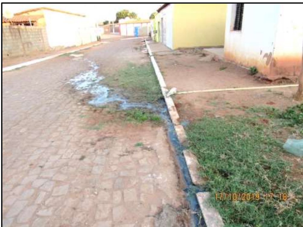
Figura 41 - Esgoto a céu aberto na Sede de João Costa Fonte: NERAR ENGENHARIA (2019)
