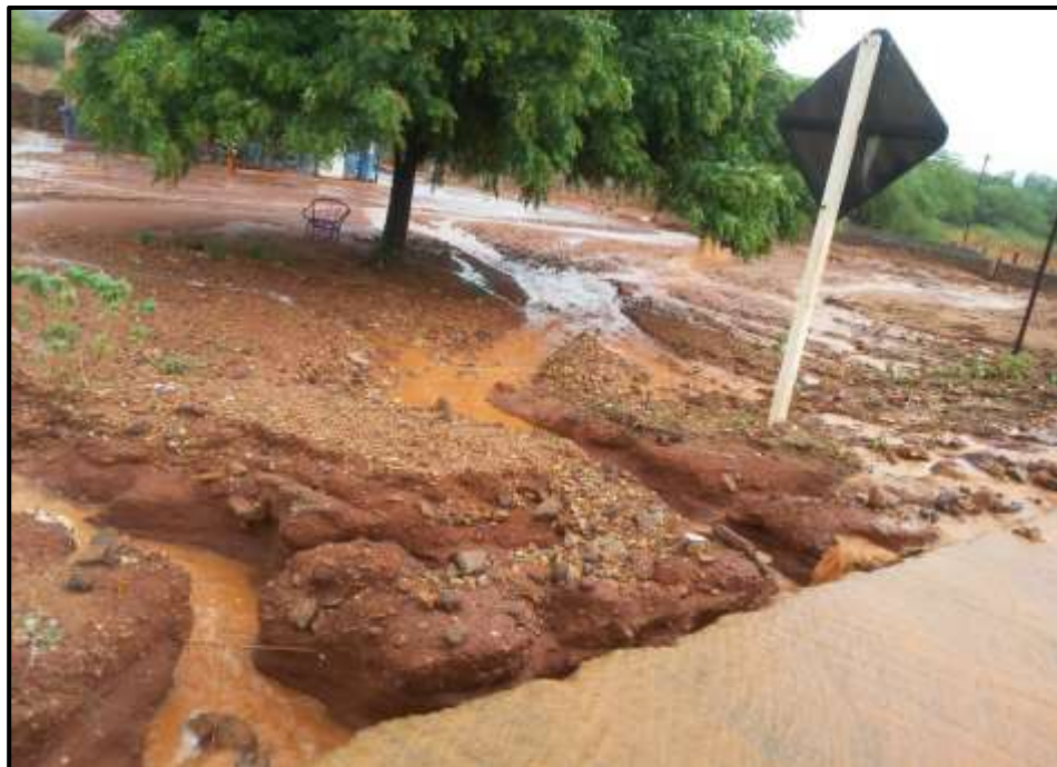
Figura 74 – Erosão na Sede de João Costa (chuva do final do ano de 2019) Fonte: Grupo de Trabalho (2019)
